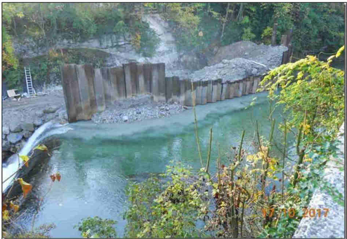
Abb. 3: Blick auf die Vorschüttung mit Spundwand im Bereich der zerstörten Konglomerat-Insel (17.10.2017). Gut erkennbar die Abwasserfahne von der konsenslosen Einleitung schwebstoffreicher Baugrubenabwässer.
